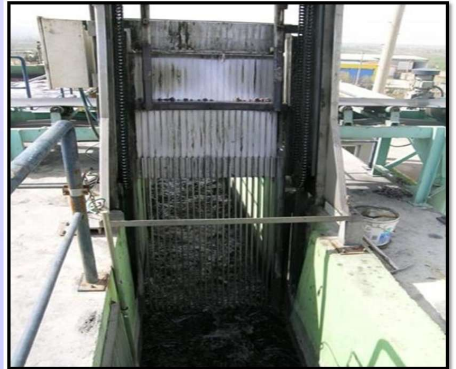
Atıksu yaklaşım kanalında çalışmakta olan ızgara.
